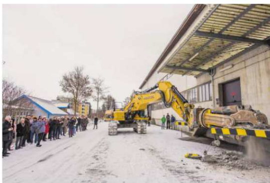
Im Beisein der Aktionäre, des Verwaltungsrats und der künftigen Mieter wird mit schwerem Gerät der Spatenstich für das Haus der Medizin Klettgau vollzogen. Bild: Daniel Thüler
